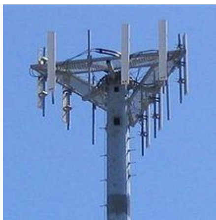
Рис. 1 - Антенны трех базовых станций на мачте
